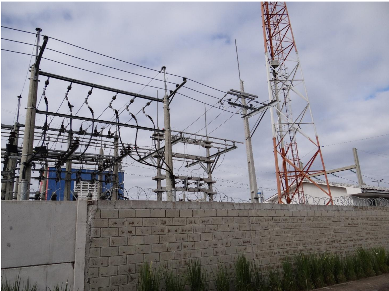
Fotografia 1: Saída do novo alimentador PEL1-112 da Subestação Pelotas 1
