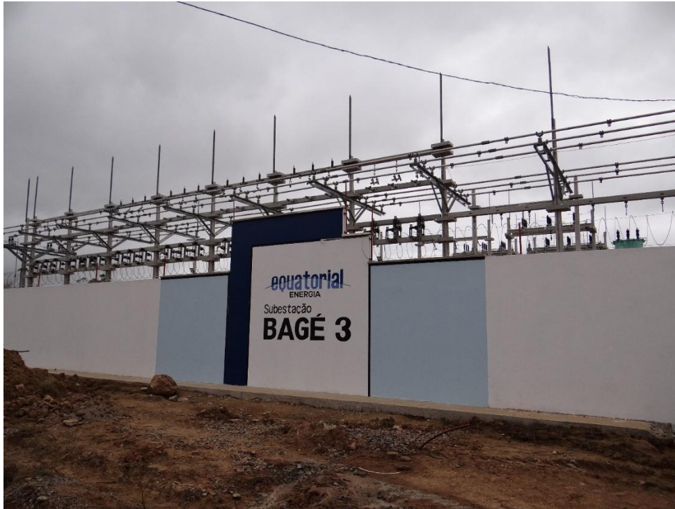
Fotografia 12: Nova Subestação BAG-3 (1)
