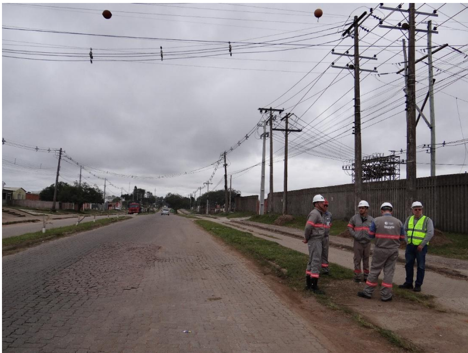
Fotografia 15: Saída dos alimentadores da SE BAG-1 tiveram sua rede compactada
