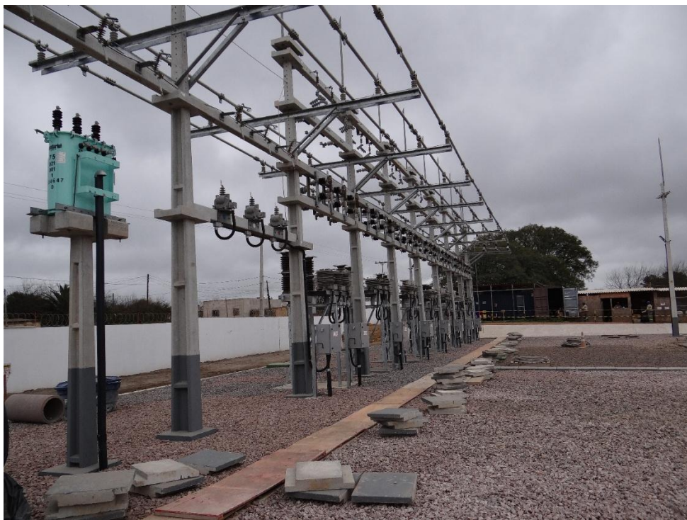
Fotografia 13: Nova Subestação BAG-3 (2)
