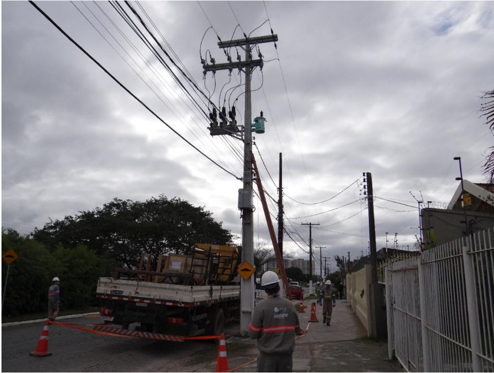
Fotografia 2: Novo religador automatizado no alimentador PEL1-107
