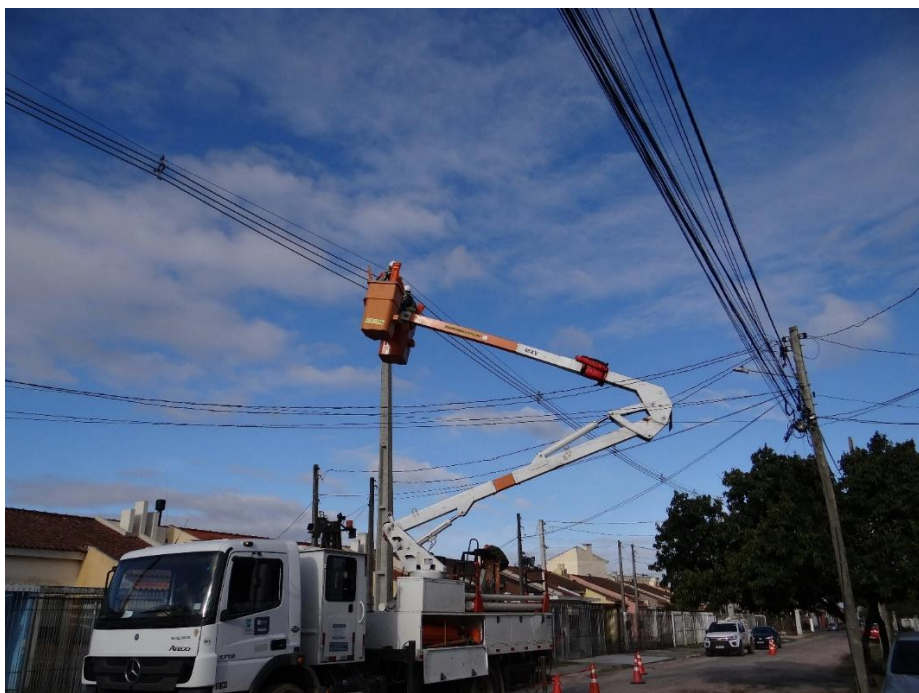
Fotografia 5: Novo alimentador da Subestação PEL4
