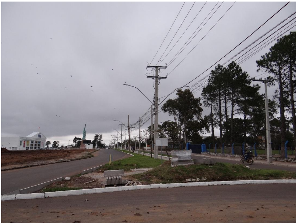
Fotografia 11: Alimentadores BAG2-27 e BAG2-28 em rede compacta
