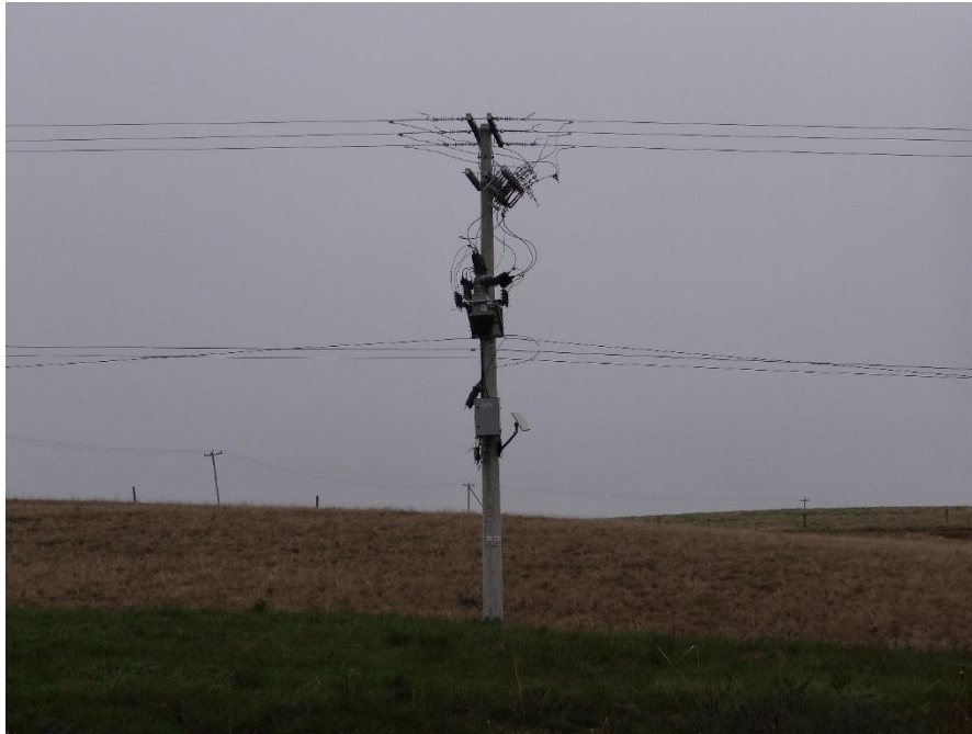
Fotografia 8: Interligação entre alimentadores UPME-4 e UPME-5
