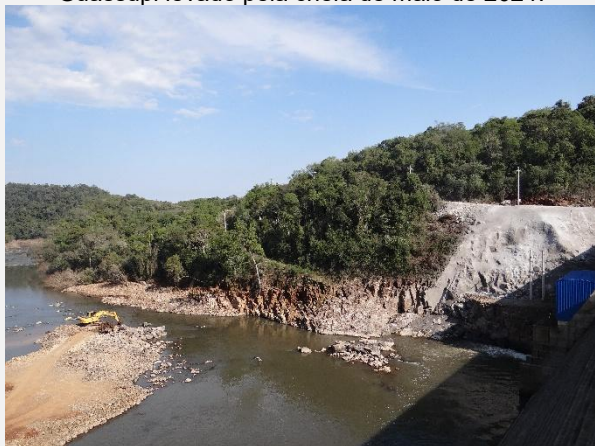
Acesso a casa de força secundária da PCH Salto do Guassupi levado pela cheia de maio de 2024.
