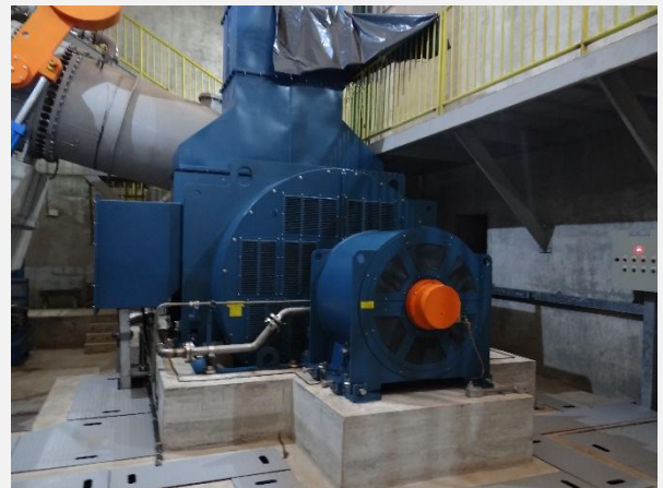
Casa de Máquinas da PCH Quebra Dentes.
