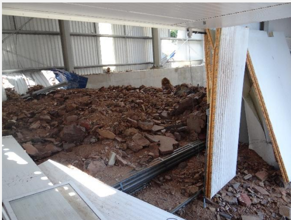
Interior da casa de força da PCH Salto do Guassupi.
