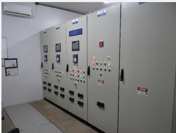
Sala de Controle Casa de Máquinas da PCH Cachoeira Cinco Veados.
