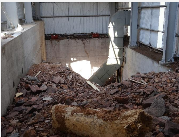
Casa de força da PCH Salto do Guassupi.
