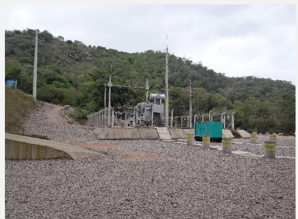
Subestação de Energia Elétrica da PCH Quebra Dentes.
