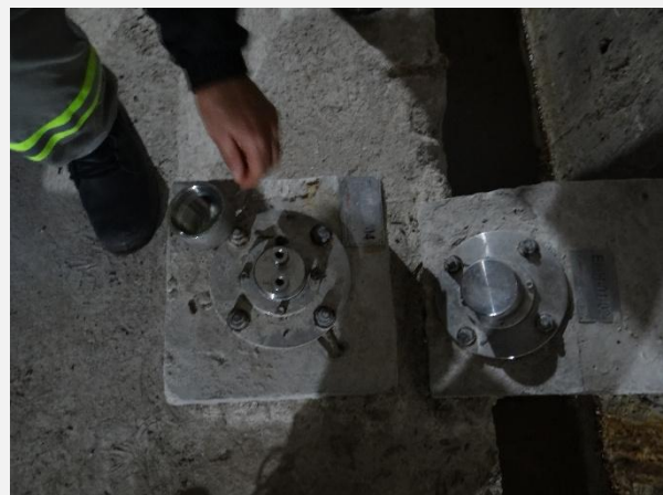
Instrumentação na Galeria de Drenagem da Barragem da PCH Cachoeira Cinco Veados.
