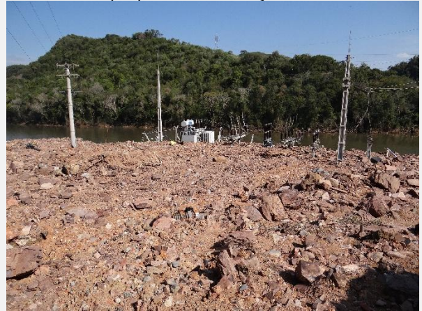
Subestação de energia elétrica da PCH Salto do Guassupi após o evento de junho de 2025.
