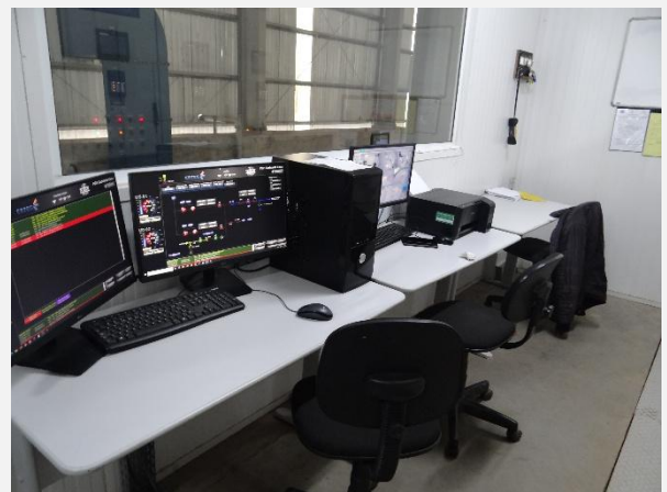
Sala de Controle e Casa de Máquinas da PCH Cachoeira Cinco Veados.
