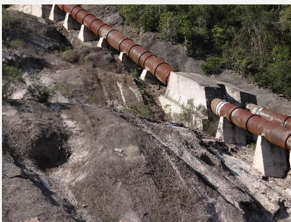
Conduto forçado da PCH Salto do Guassupi.
