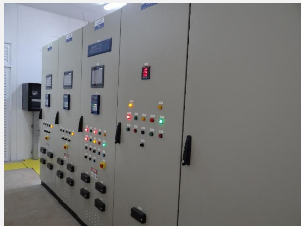
Sala de Controle da PCH Rincão São Miguel.
