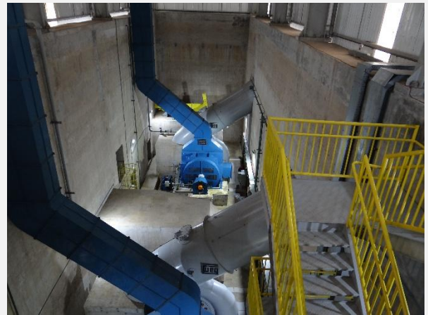
Casa de Máquinas da PCH Cachoeira Cinco Veados.
