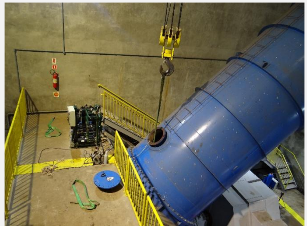
Gerador em manutenção na PCH Rincão São Miguel.
