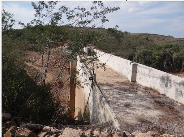
Finalização da obra na margem direita da barragem da PCH Salto do Guassupi.
