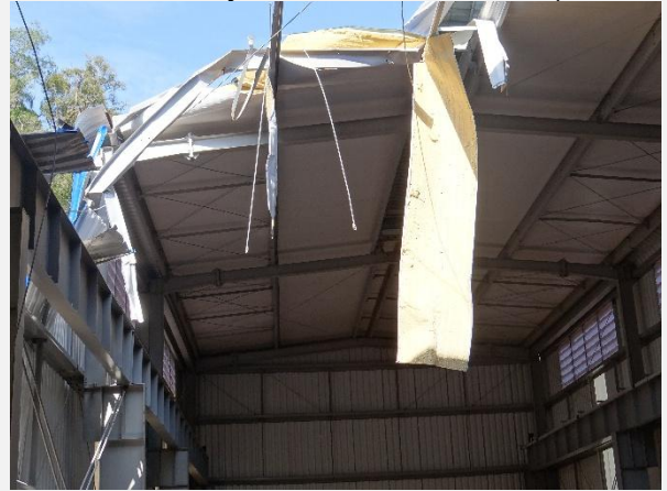
Casa de força da PCH Salto do Guassupi.
