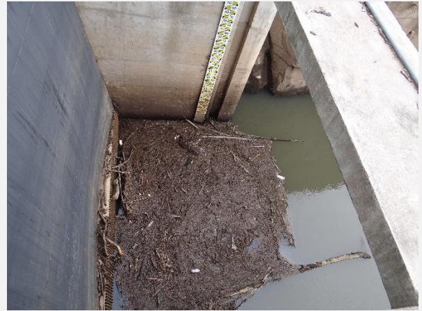
Tomada d'água da PCH Quebra Dentes.
