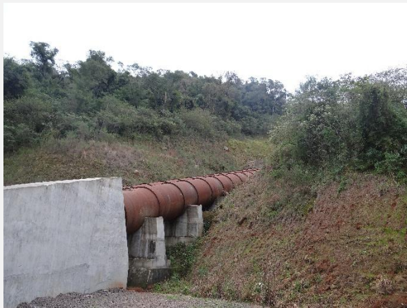
Tubulação de Adução da PCH Cachoeira Cinco Veados.
