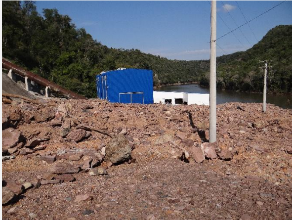
Casa de força da PCH Salto do Guassupi sob detritos e material carreado do deslocamento de terra.
