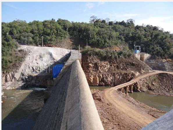
Acesso provisório para manutenção do túnel de adução e acesso à margem esquerda da barragem da PCH Salto do Guassupi.
