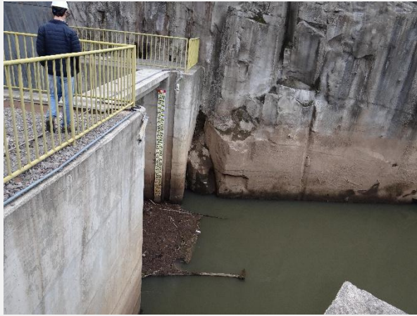
Tomada d'água da PCH Quebra Dentes.
