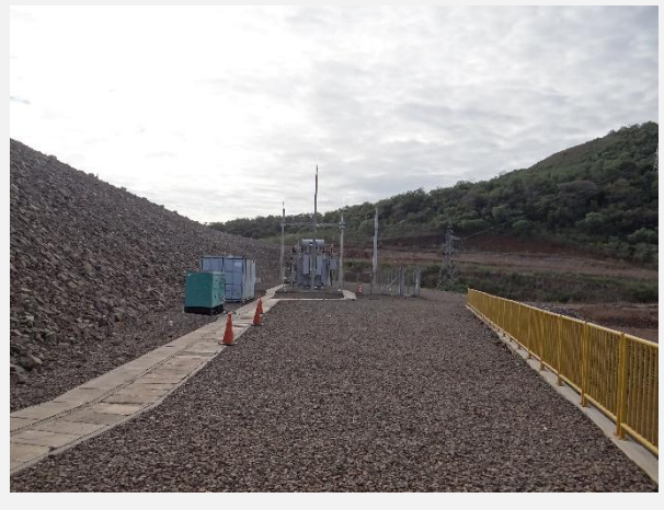
Subestação Elétrica da PCH Rincão São Miguel.
