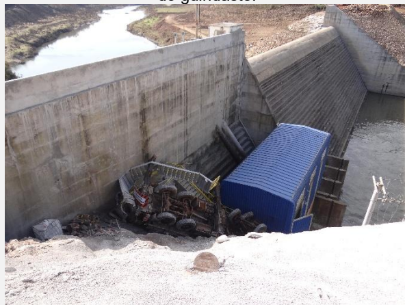
Acesso por escada à casa de força secundária da PCH Salto do Guassupi, destruído pelo acidente de queda do guindaste.
