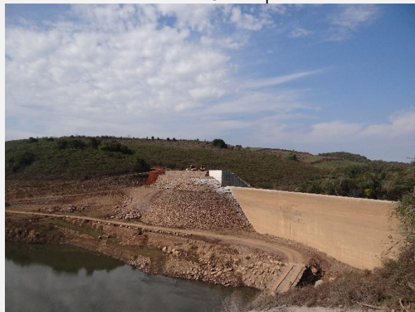
Vista da margem direita. Finalização da obra da barragem na margem esquerda montante da PCH Salto do Guassupi.
