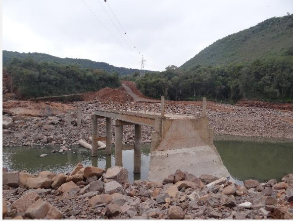
Acesso à margem direita da PCH Cachoeira Cinco Veados, destruído pelos eventos de maio de 2024.
