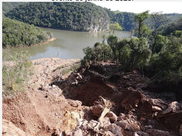
Deslocamento de terra e destruição do acesso à Casa de Força da PCH Salto do Guassupi em função do evento de junho de 2025.
