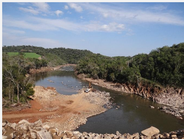
Vista para a jusante da barragem, retirada de material do leito do rio Guassupi.
