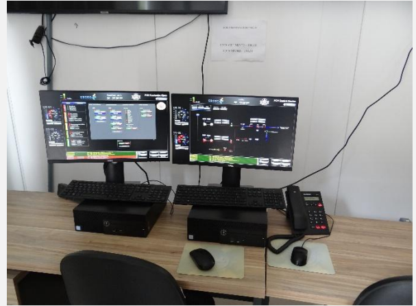
Sala de Controle na Casa de Máquinas da PCH Quebra Dentes.
