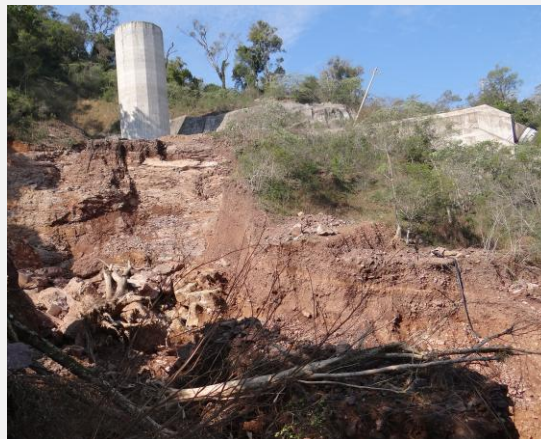
Estragos causados pela força das águas do evento de junho de 2025 nos acessos à casa de força próximo à chaminé de equilíbrio da PCH Salto do Guassupi.
