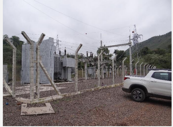
Subestação de Energia Elétrica da PCH Cachoeira Cinco Veados.
