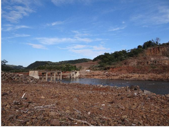
Acesso à margem esquerda da PCH Rincão São Miguel, destruído pelos eventos de maio de 2024.
