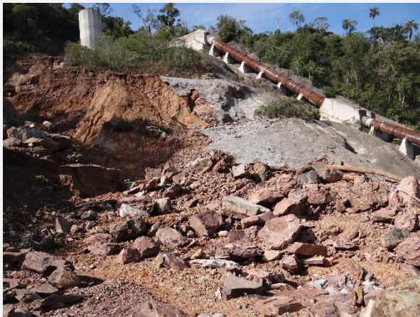
Segmento do conduto forçado da PCH Salto do Guassupi.
