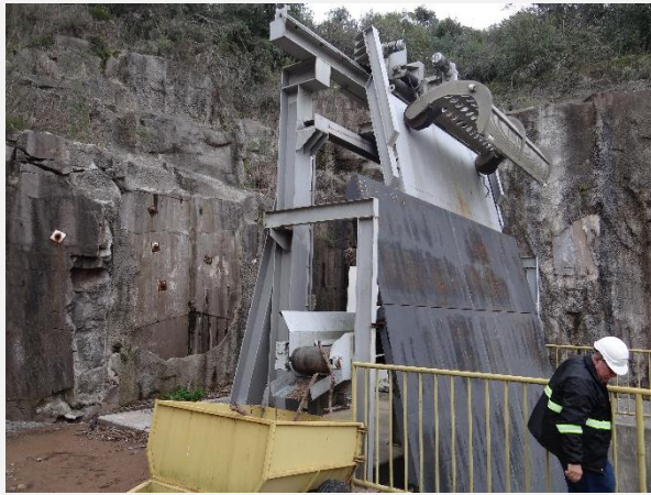
Limpa-grades da Tomada d'água da PCH Quebra Dentes.
