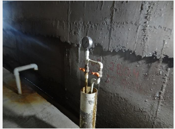
Instrumentação na Galeria de Drenagem da Barragem da PCH Cachoeira Cinco Veados.
