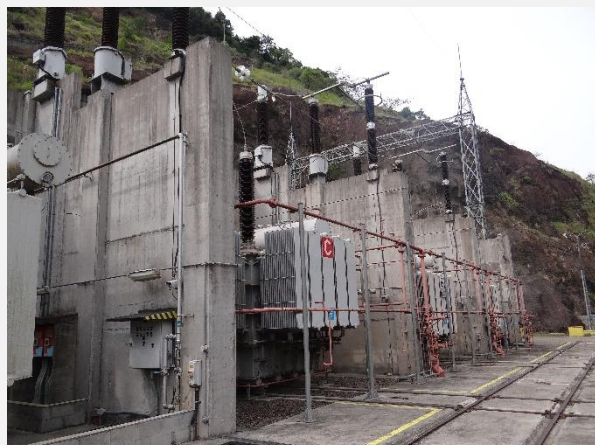
Subestação elétrica associada da UHE Castro Alves.
