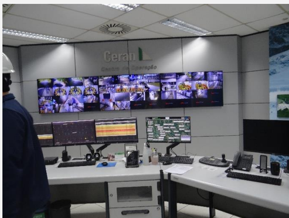
Centro de operação da UHE Monte Claro.
