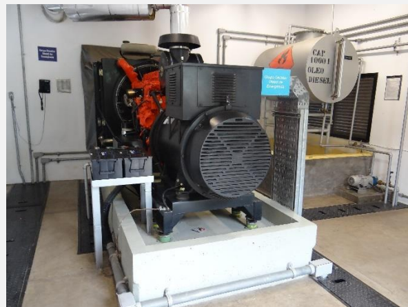
Sala de Gerador de Emergência da UHE Castro Alves.
