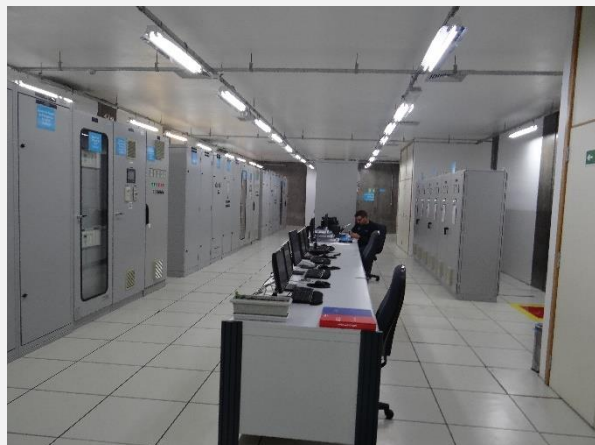
Sala de controle da UHE Castro Alves.
