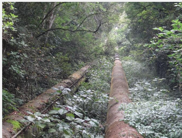
Conduto forçado da UHE Canastra.
