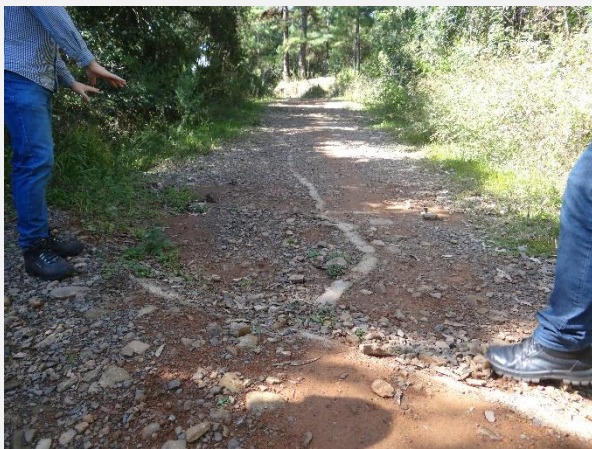
Preenchimento com concreto das fissuras que surgiram no talude da margem esquerda da barragem do Salto.
