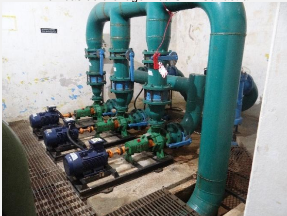
Bombas de drenagem da UHE Canastra.
