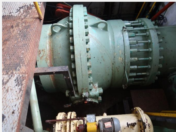
Válvula de admissão da casa de força da UHE Bugres.
