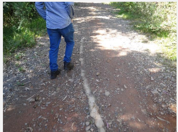
Preenchimento com concreto das fissuras que surgiram no talude da margem esquerda da barragem do Salto.
