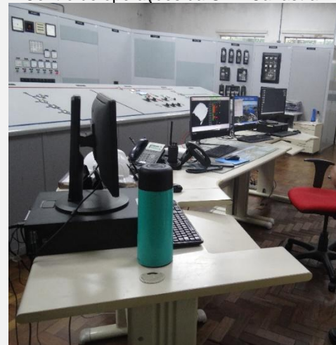
Centro de operações da UHE Canastra.
