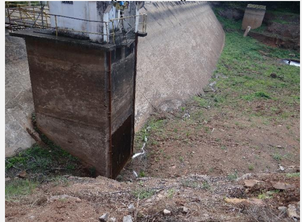
Tomada d'água da Barragem Canastra.
