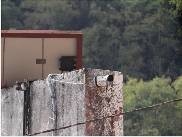
Câmera de monitoramento do talude da margem esquerda de montante da barragem Canastra.
