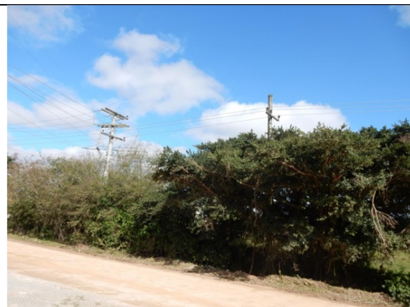
Foto 16 – SE Pelotas 3 – saída dos alimentadores.
