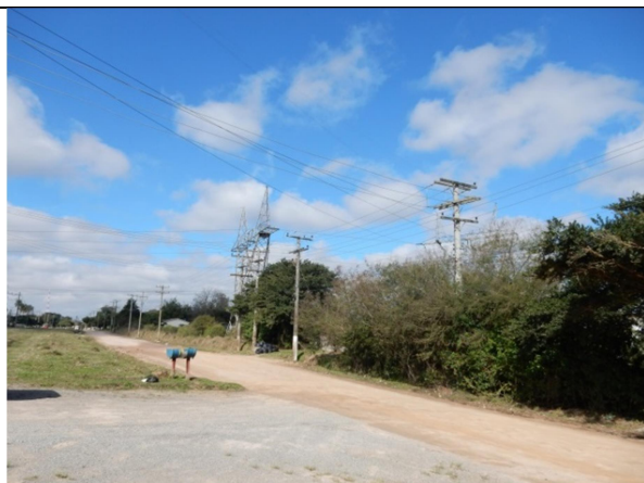
Foto 15 – SE Pelotas 3 – saída dos alimentadores.
