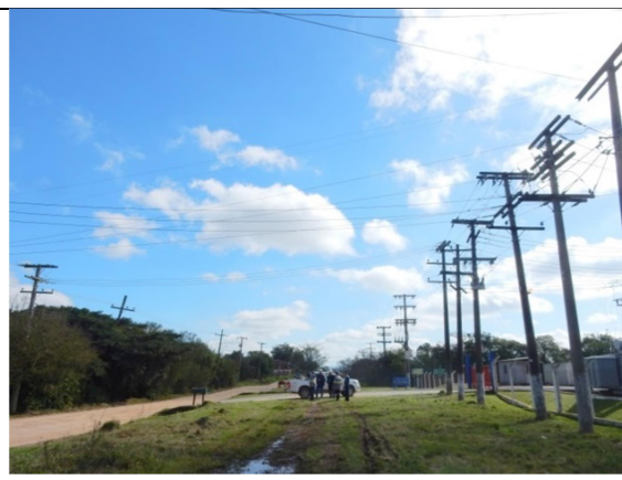
Foto 18 – SE Pelotas 3 – saída dos alimentadores.
