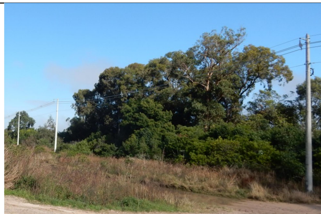
Foto 29 – Rede compacta com dois espaçadores no vão.
