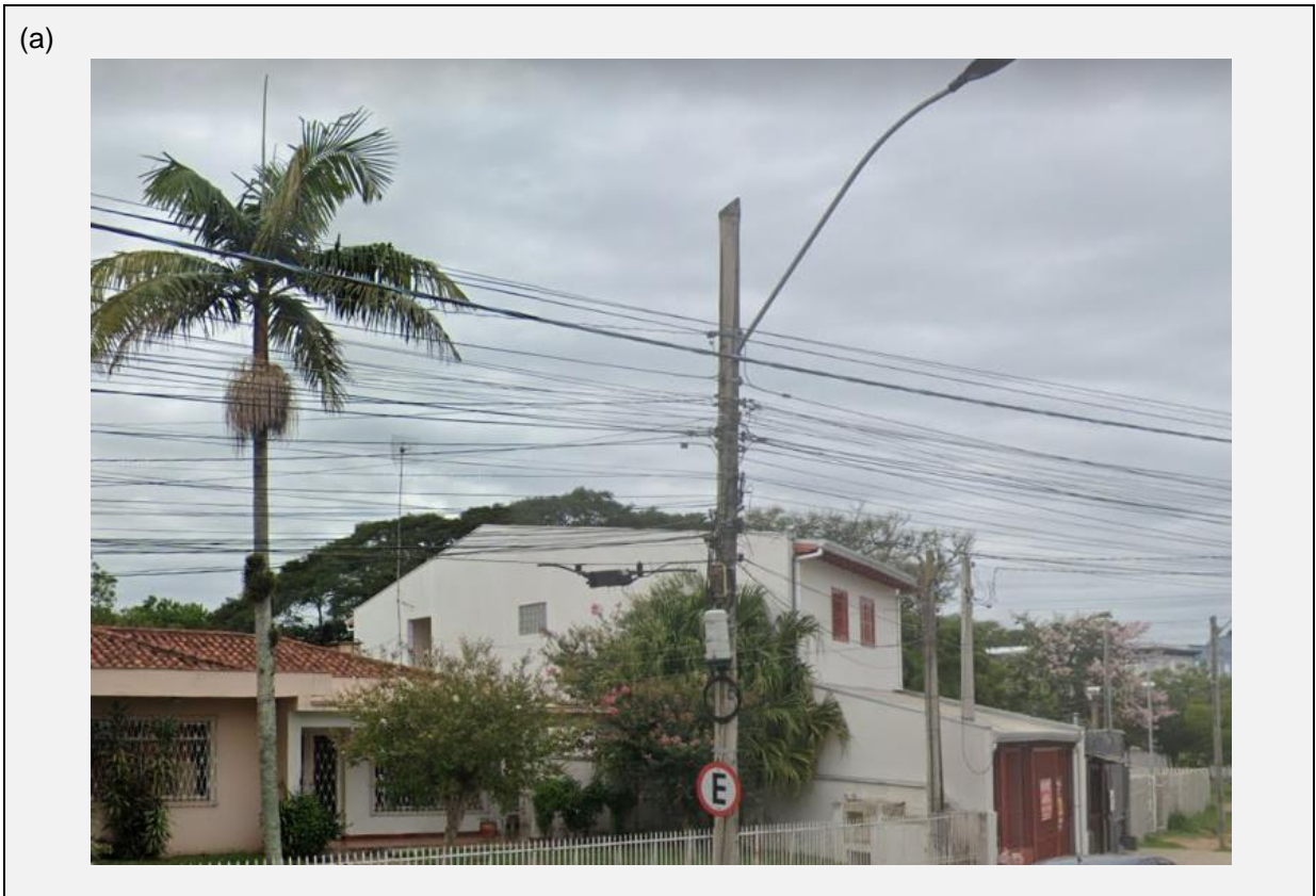
Figura 5 – Fotos do compartilhamento da infraestrutura da CEEE-D Equatorial no município de Viamão, na Rua Coronel Mário Antunes da Viega.
