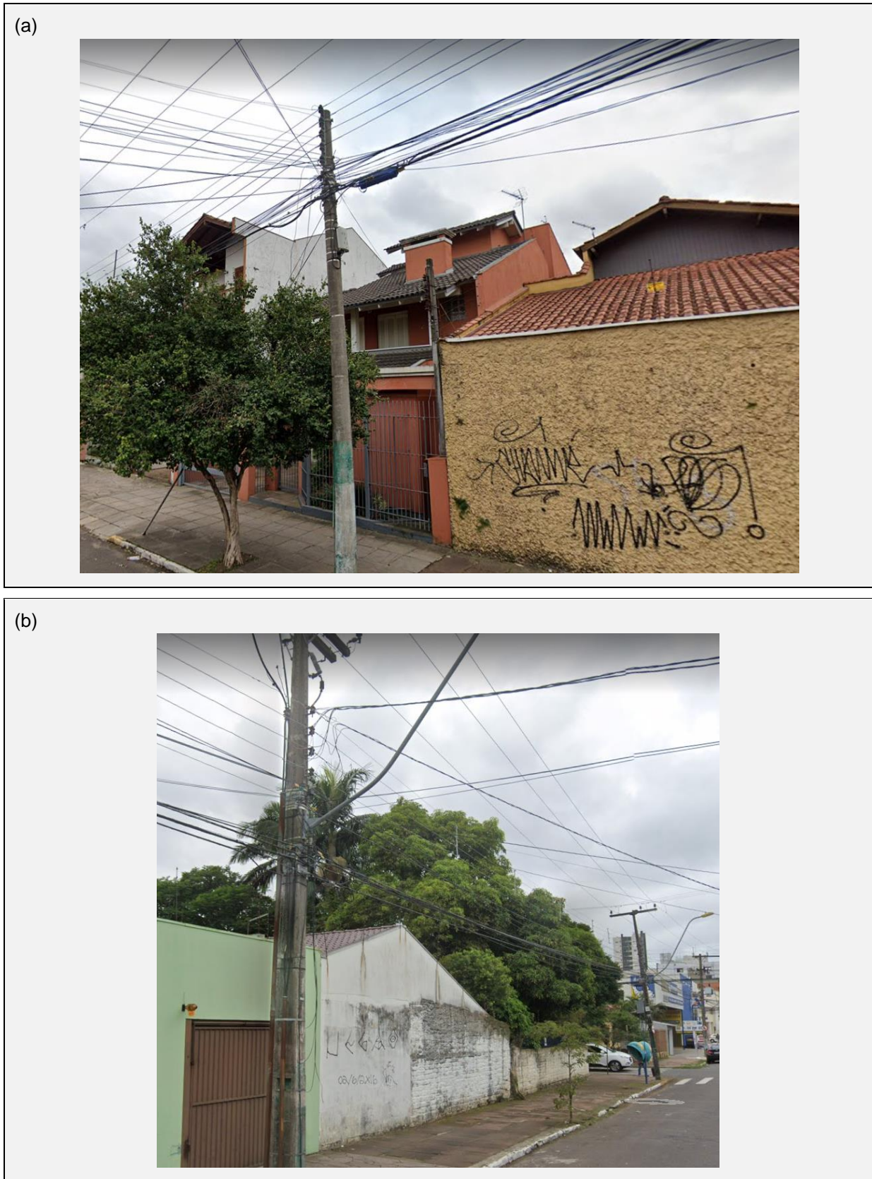
Figura 4 - Fotos do compartilhamento da infraestrutura da RGE no município de São Leopoldo, na Rua São Caetano.
