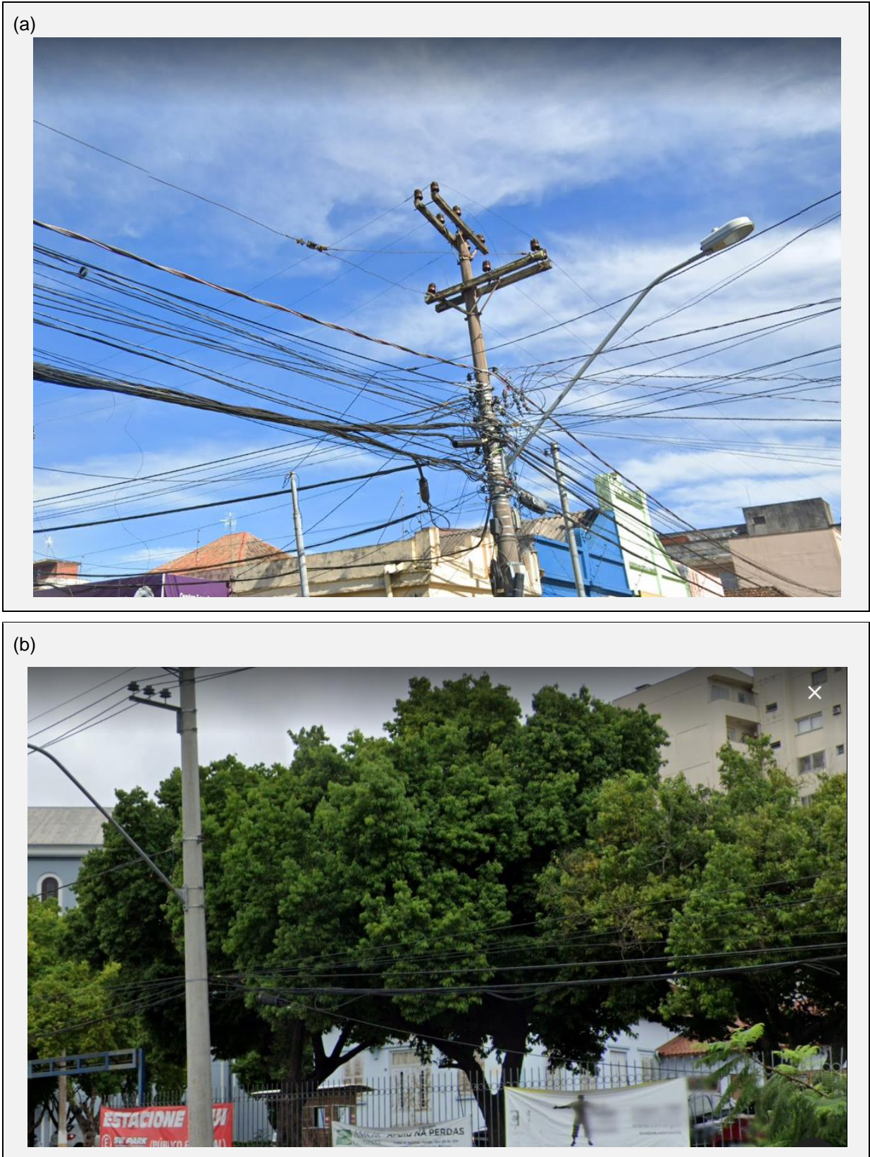
Figura 1 - Fotos do compartilhamento da infraestrutura da RGE no município de Novo Hamburgo, Rua Joaquim Nabuco.
