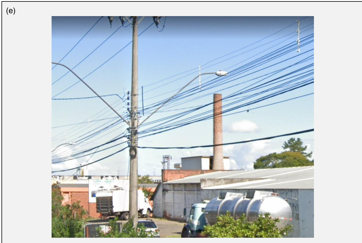
Figura 2 (cont.) - Fotos do compartilhamento da infraestrutura da RGE no município de Novo Hamburgo, na Rua Ver. Adão Rodrigues de Oliveira.
