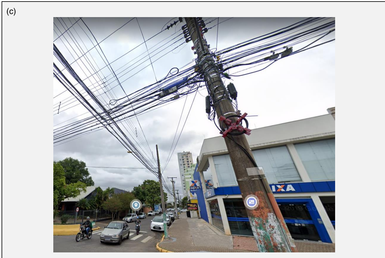
Figura 4 (cont.) - Fotos do compartilhamento da infraestrutura da RGE no município de São Leopoldo, na Rua São Caetano.
