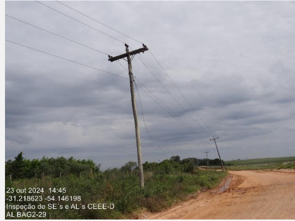
Foto 282 (e) Estai solto, sem manutenção.
