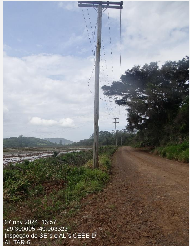
Foto 345 (d) Estai solto, sem manutenção
