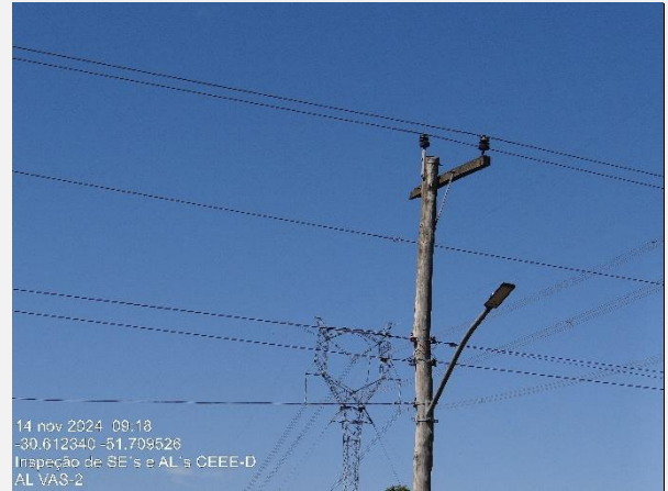
Foto 404 (d) Cruzeta danificada, podre ou em mau Estado
