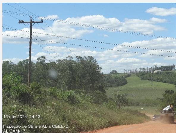
Foto 388 (d) Cruzeta danificada, podre ou em mau Estado
