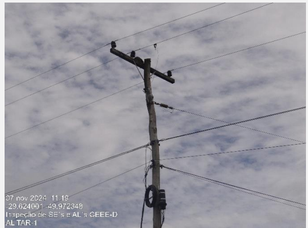
Foto 337 (d) Cruzeta danificada, podre ou em mau Estado
