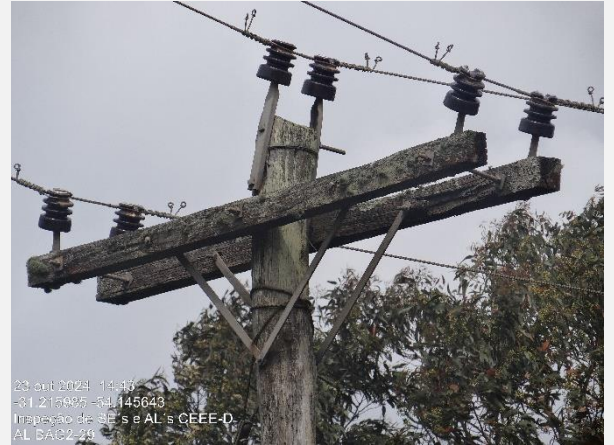
Foto 281 (d) Cruzeta danificada, podre ou em mau Estado
