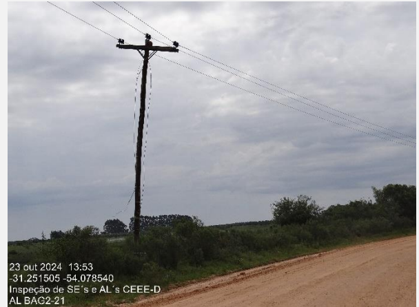
Foto 273 (d) Estai sem fixação – solto.
