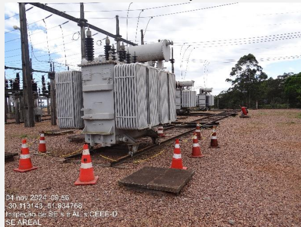
Foto 82 (e) Trafo reserva não possui Bacia de Contenção.
