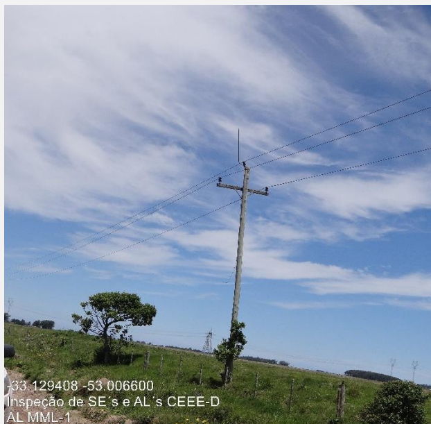
(a) Para-raio com aterramento rompido.
