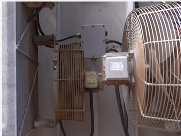
Foto 81 (c) Sistema de ventilação forçada - 1 ventilador inoperante.
