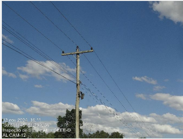
Foto 395 (c) Cruzeta danificada, podre ou em mau Estado.
