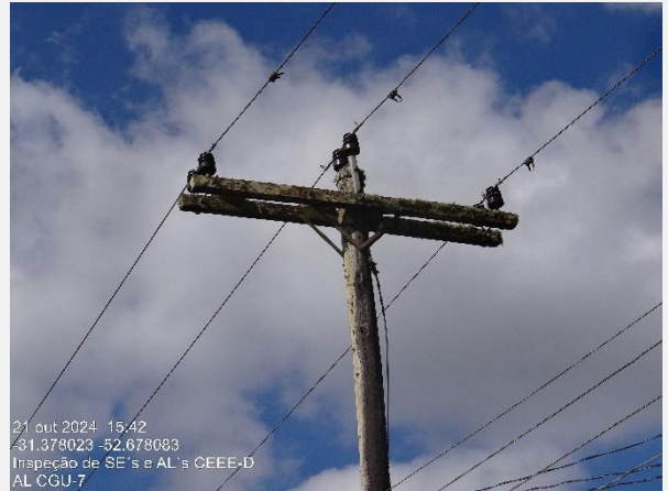
Foto 233 (d) Cruzeta danificada, podre ou em mau Estado.
