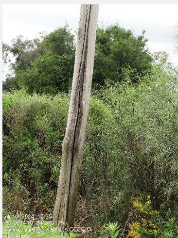
Foto 287 (c) Poste de Madeira Danificado, Podre ou em Mau Estado.
