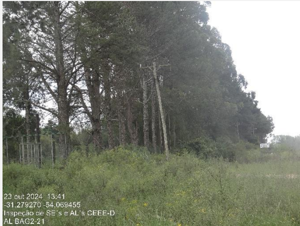
Foto 272 (c) Poste fora do prumo.
