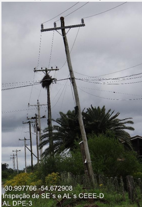
Foto 285 (a) Poste fora do prumo.
