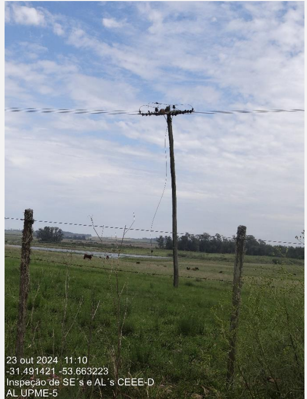
Foto 265 (d) Estai sem fixação - solto
