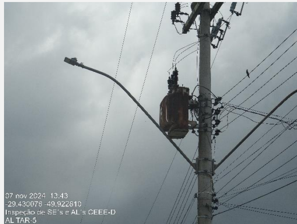
Foto 346 (a) Transformador com corrosão/ferrugem.
