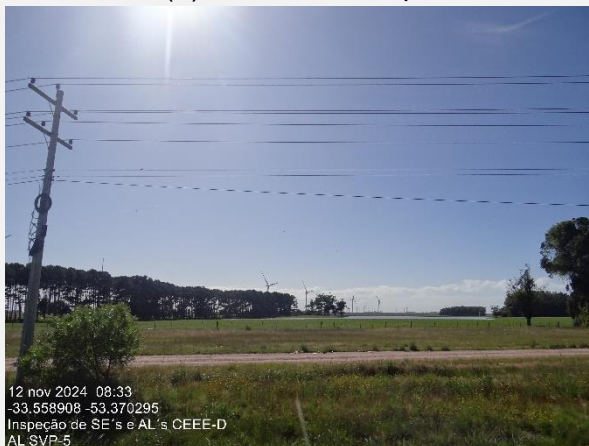
(b) Poste fora do prumo
