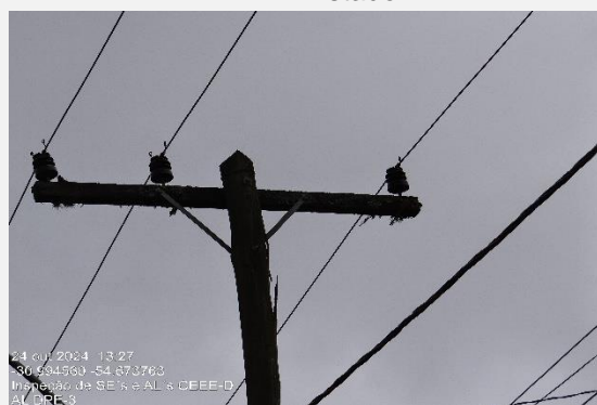
Foto 288 (d) Cruzeta de Danificada, Podre ou em Mau Estado.
