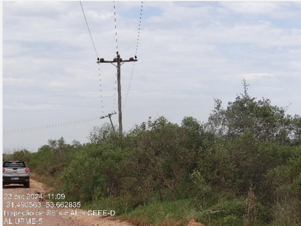
Foto 264 (c) Poste fora do prumo.
