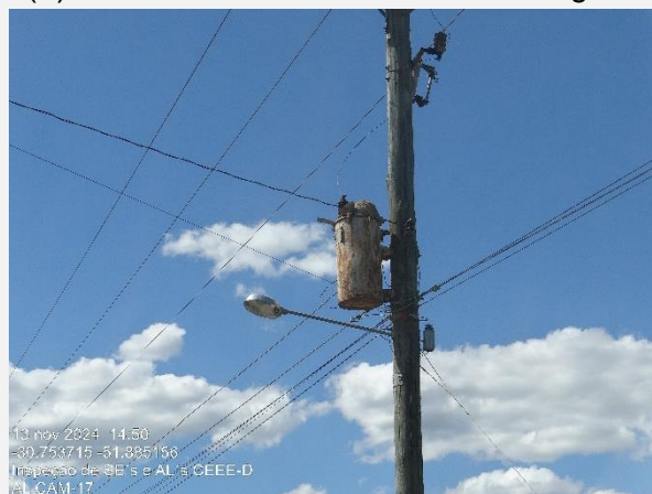
Foto 389 (a) Transformador com corrosão/ferrugem.
